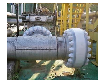
TERMINAL DE GÁS
